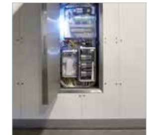
Elektroverteilung hinter Feuerschutz-Wandklappe T90.
